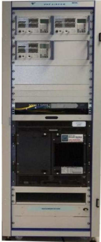
Figura 5: Ejemplo de Rack VHF Data Link
